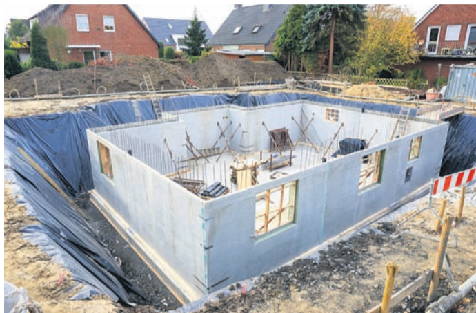
Gesunder Wohnkomfort braucht Schutz vor Schadstoffen. Deswegen sollten Keller durch eine geeignete Dickbeschichtung vor dem Eindringen radioaktiver Gase geschützt werden.
